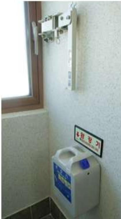
<완강기 설치 상태>
