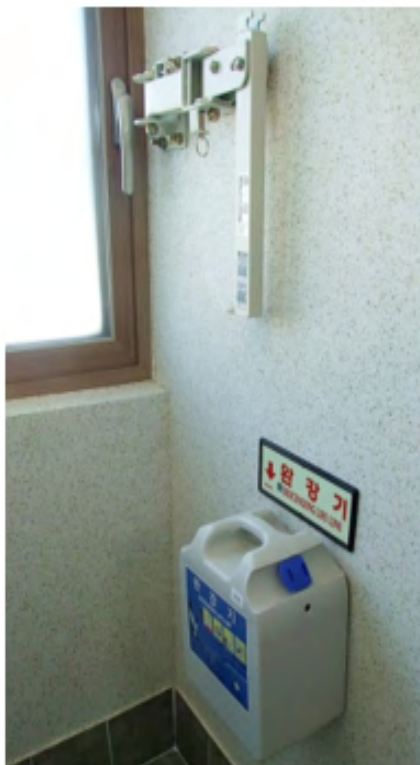
<완강기 설치 상태>
