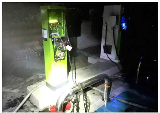
전기차 충전시설 지하 화재 발생 사례
