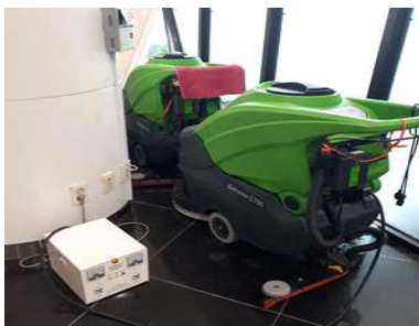
복도에 충전기 설치 후 청소차 충전 (잘못된 사례)
