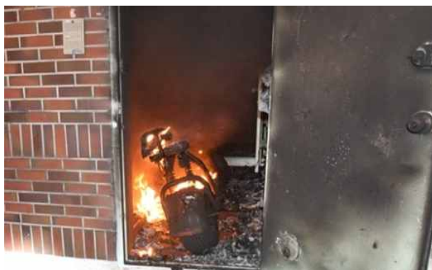
전기스쿠터 충전 배터리 화재 발생 사례
