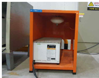
충전기 전용박스 자동화산소화기 설치 (우수사례)
