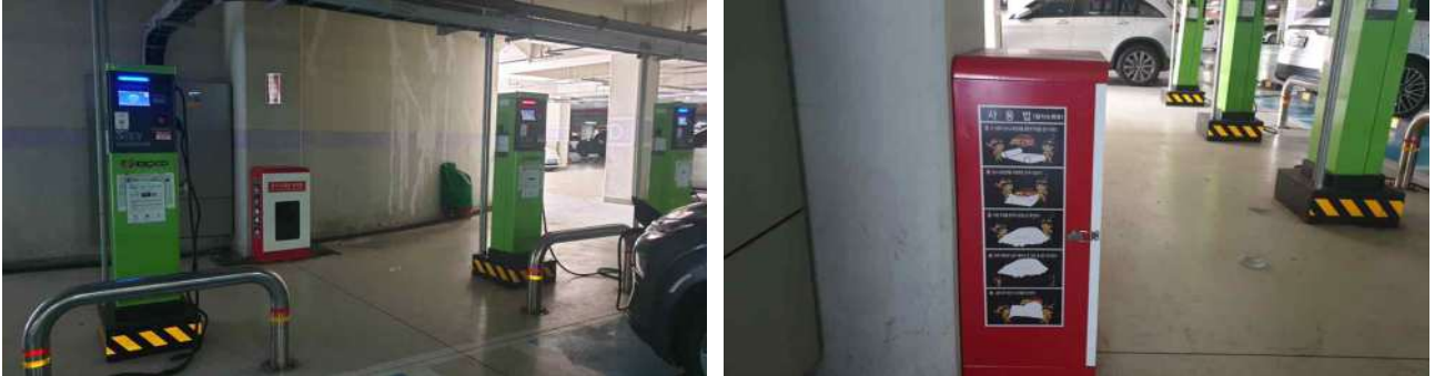
<그림 37> 충전구역 뒤편에 설치된 질식소화포 및 안전장구
