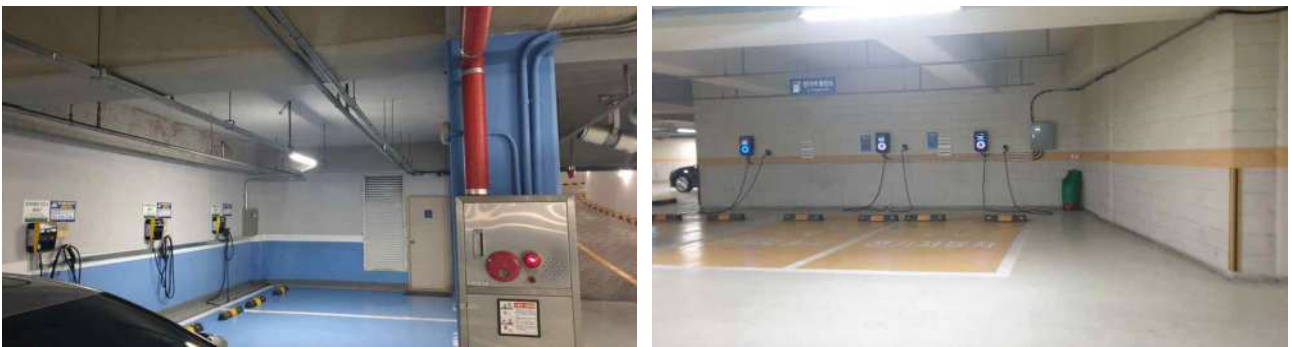
<그림 35> 화재감지기가 설치되지 않은 전기차 충전구역
