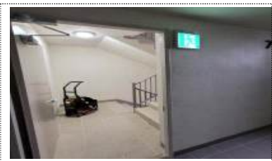
송풍기 작동시 방화문 폐쇄
